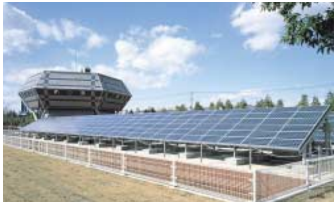
太陽光発電施設
