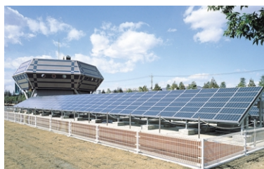
太陽光発電施設
