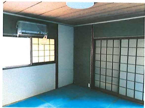
図 3-6.作業途中の既存壁面との色目の差
