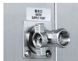
純水供給口(減圧弁付)
