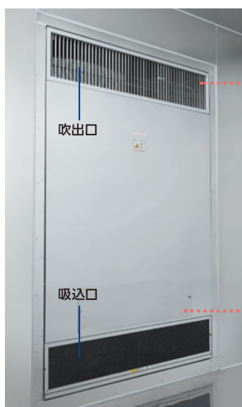
試験室内空調器
