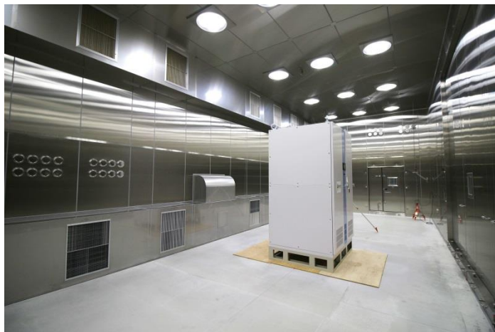
大型恒温恒湿室
