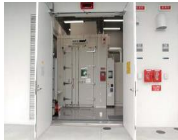
充放電試験用の恒温恒湿室
