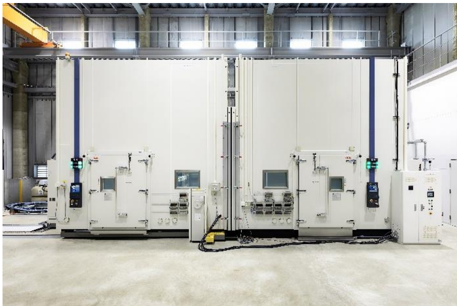
恒温(恒湿)室 建材用試験室
