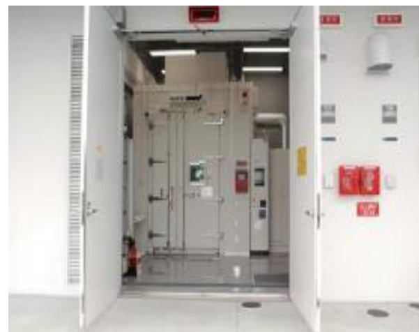
充放電試験用の恒温恒湿室
