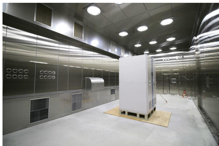
大型恒温恒湿室
