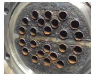
■ インバーターチラー使用時の水冷凝縮器内部
